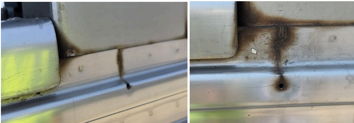
Figura 05: Fissuras no corrugado da caixa do TUE 10 Metrô BH.
