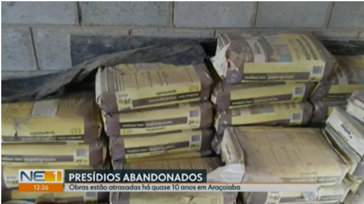
Figura 7 : excerto de reportagem sobre o abandono das obras de Construção das Cadeias Públicas no município de Araçoiaba/PE, em especial, no Lote nº 02
