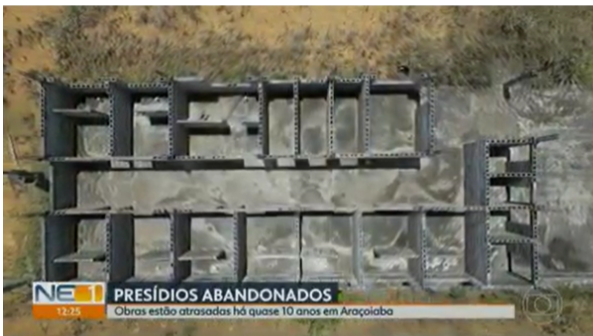
Figura 4 : excerto de reportagem sobre o abandono das obras de Construção das Cadeias Públicas no município de Araçoiaba/PE, em especial, no Lote nº 02
