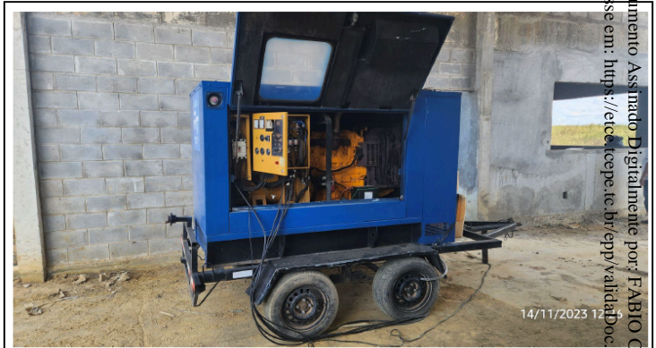
UPM-01 Lote II - Gerador para concluir a estrutura para a vigilância noturna da obra
