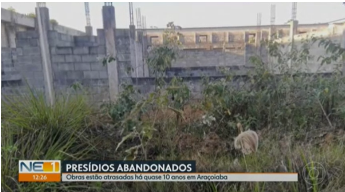
Figura 6 : excerto de reportagem sobre o abandono das obras de Construção das Cadeias Públicas no município de Araçoiaba/PE, em especial, no Lote nº 02
