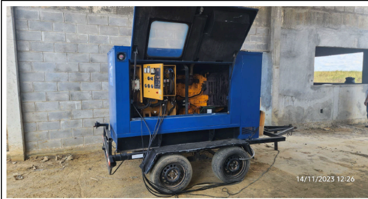
UPM-01 Lote II - Gerador para concluir a estrutura para a vigilância noturna da obra
